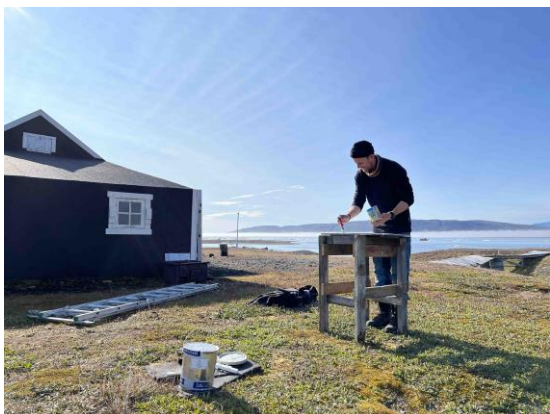
Træværket trængte til maling, gavl-geviret var løst og der var en del arbejde med tagpappet.
